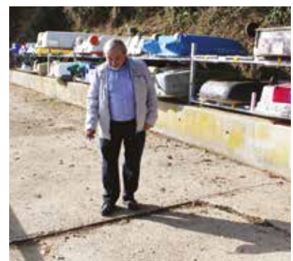
Robert Thomas, adjoint aux travaux, constate l'affaissement de la cale du Dellec.
